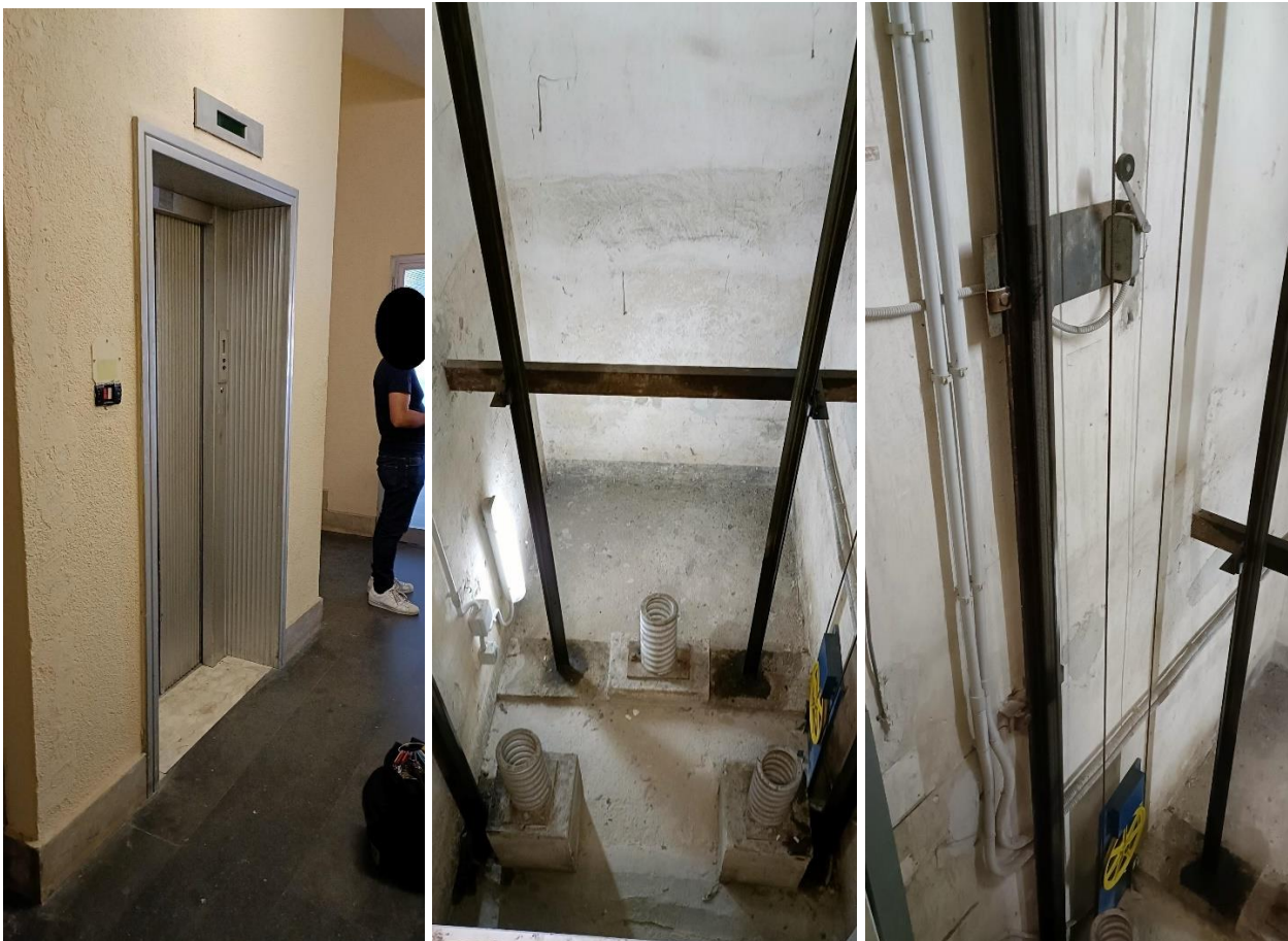
Fig. 3: vano ascensore a servizio del Centro Linguistico
