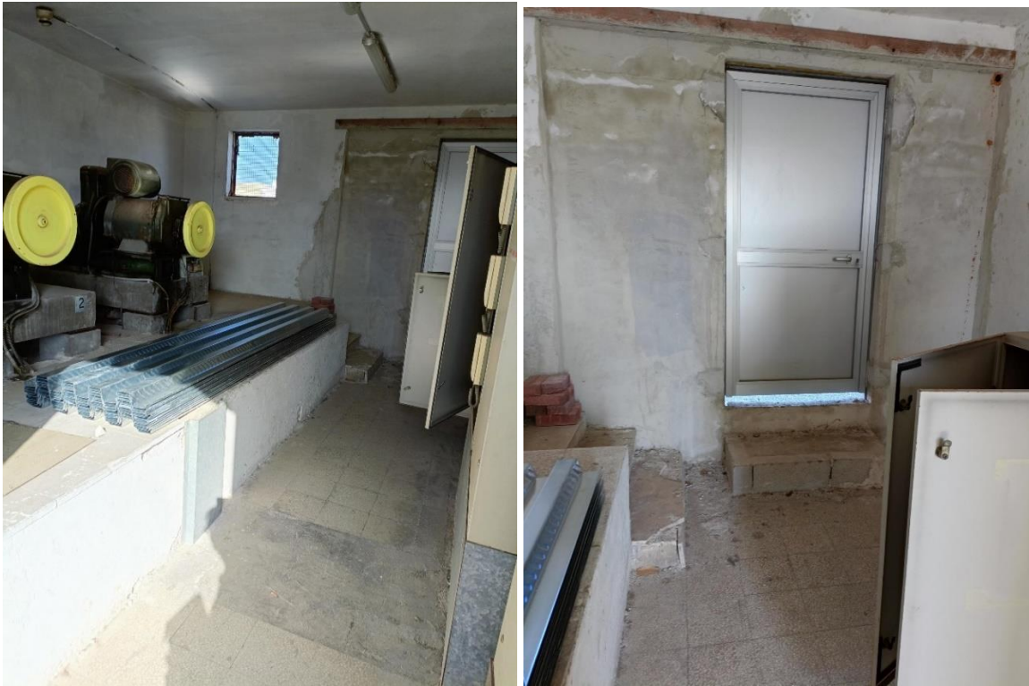
Fig. 2: locale macchine ascensori Poliba Control
