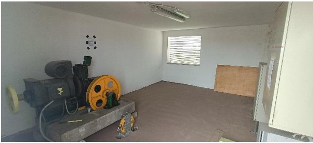
Fig. 4: locale macchine ascensore a servizio del Centro Linguistico
